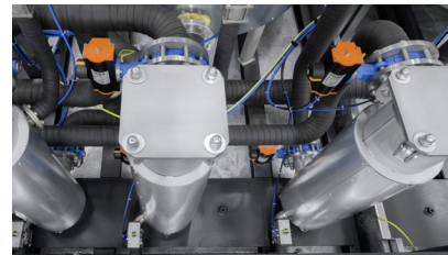
Filtration permanente du milieu dans le circuit principal
